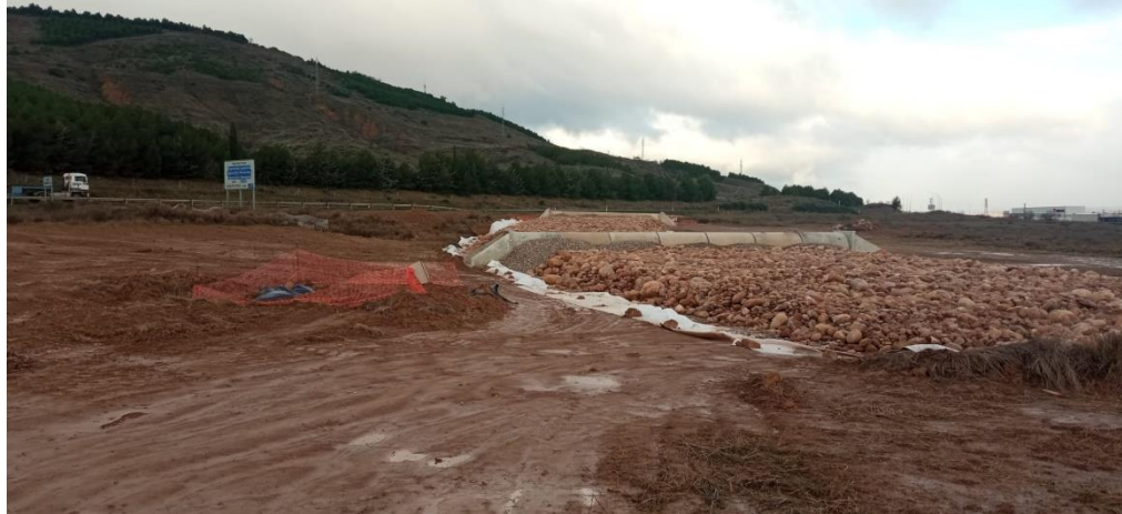
Ejecución de drenajes (Drenaje transversal y manto drenante en zona inundable junto N-232 en Arrúbal).
