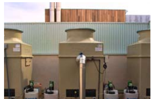
Torres de refrigeración
